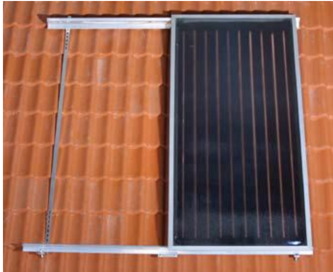
Resim 2.7: Güneş panel sisteminin son hâli
