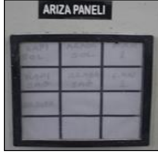
Resim 2.15: Arıza kontrol panosu
