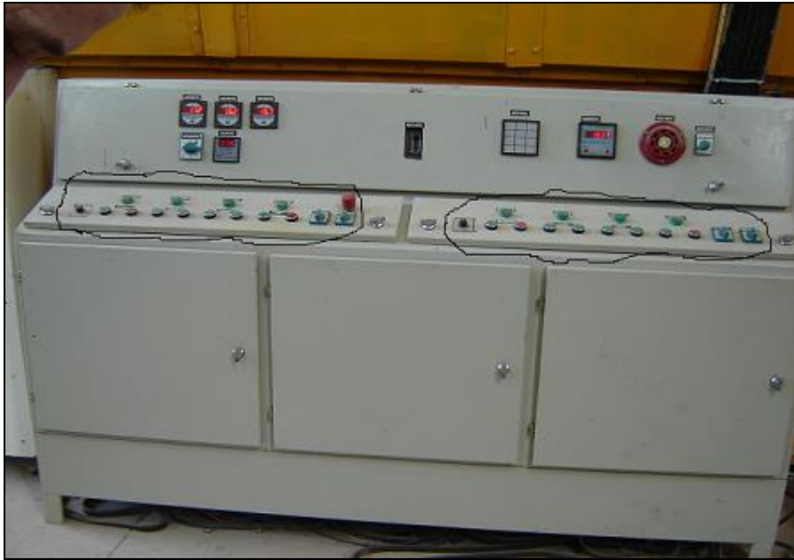
Resim 2.10: Rotasyon makinesi kontrol panosu
