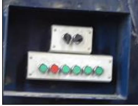
Resim 2.5: Araba kontrol panosu
