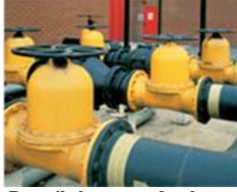
Resim 2.2: Boya ile korozyondan korunan vanalar
