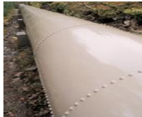
Resim 2.9: Klor kauçuk boya ile boyanmış boru
