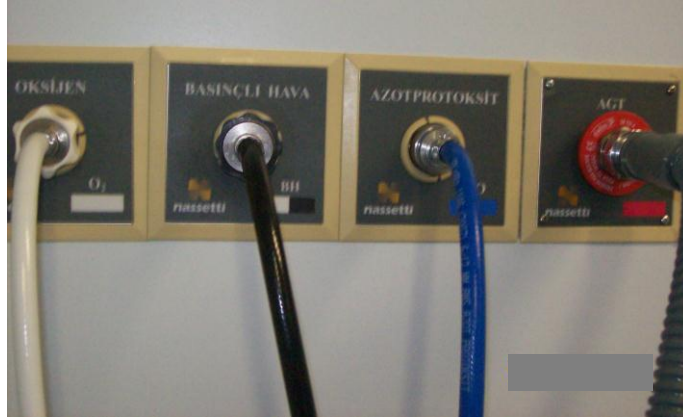
Resim 3.2: Medikal gazların ameliyathaneye giriş sistemi ( kırmızı renkli olan kısım atık gaz tahliye borusudur)
