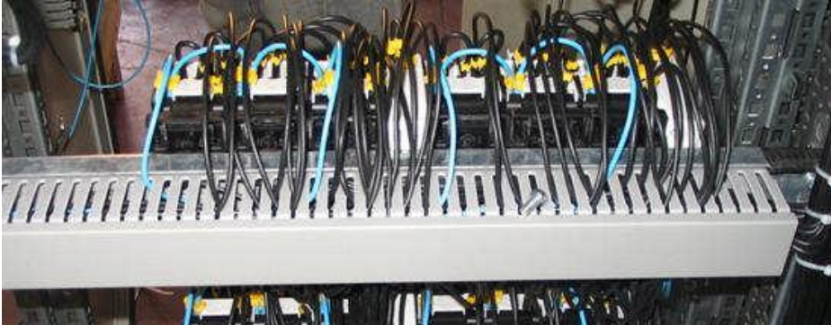
Resim 2.8: Kanal içine yerleştirilme işlemi tamamlanmış kablolar
